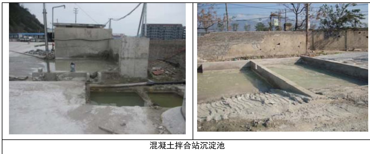
图 4.1-4 混凝土拌合站废水处理措施
