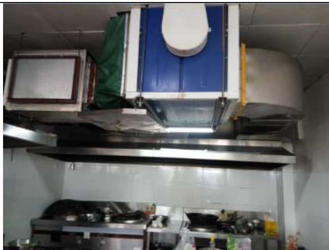
管理中心厨房油烟净化器
