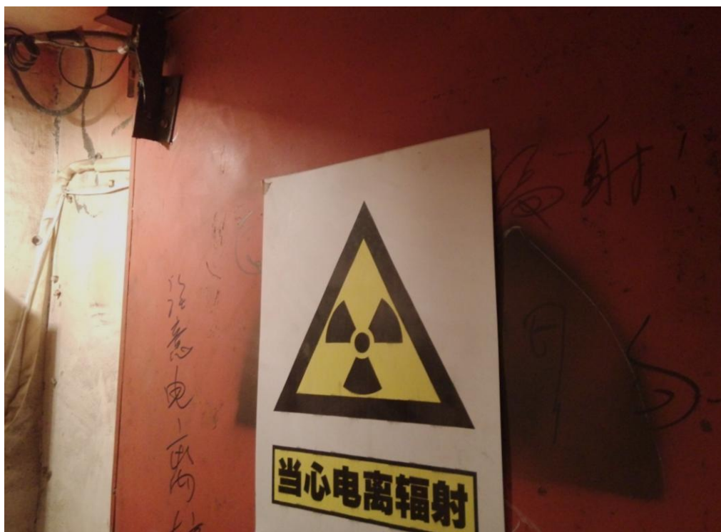
图 6-2 探伤室防护门及电离辐射标志
