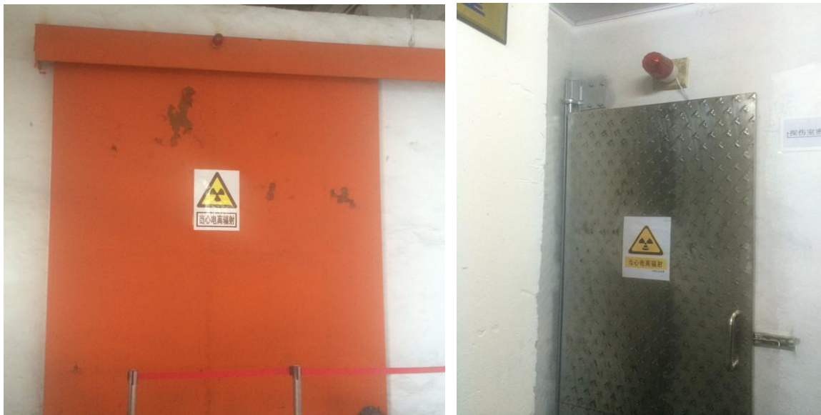
图 6-2 探伤室防护门、电离辐射标志及警示灯
