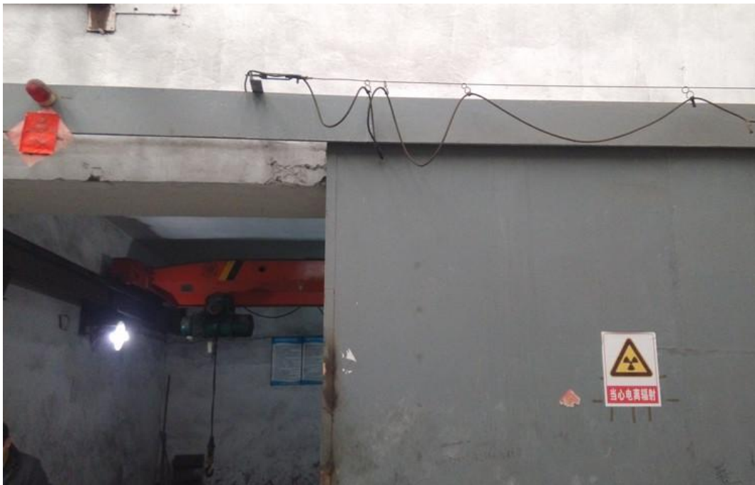
图 6-2 探伤室防护门、电离辐射标志及警示灯
