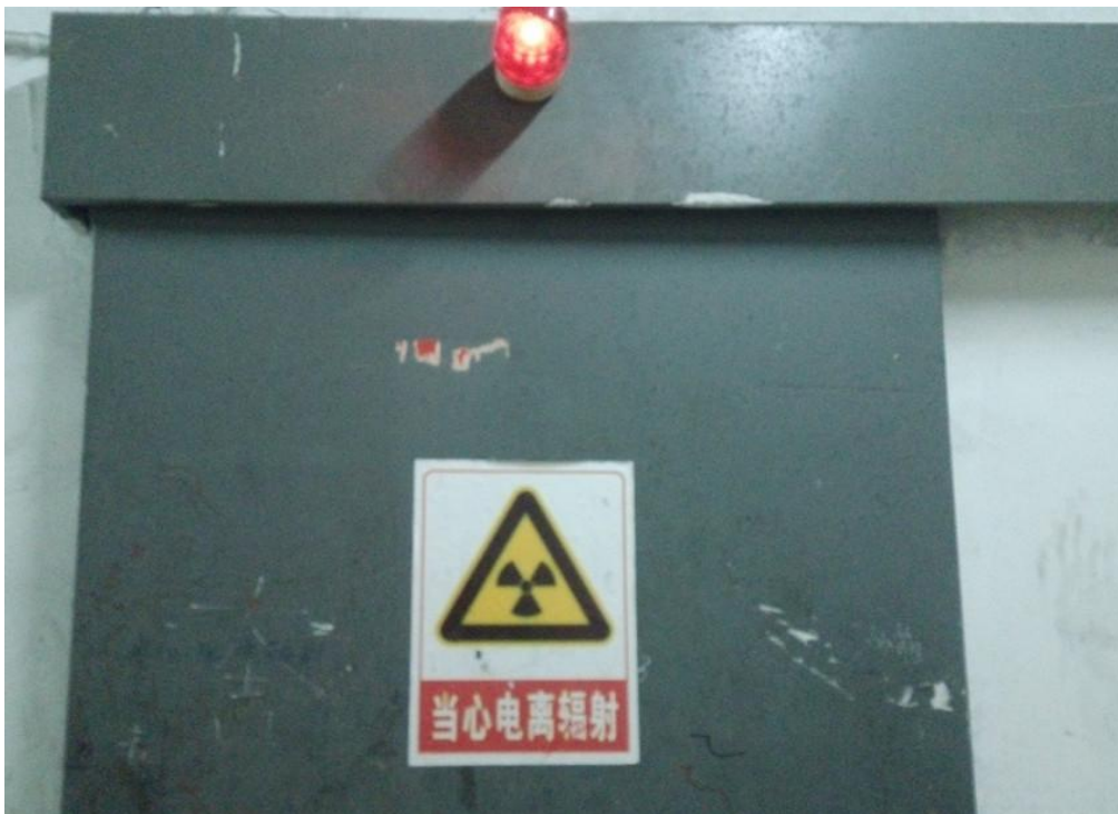
图 6-3 探伤室防护门、电离辐射标志及警示灯
