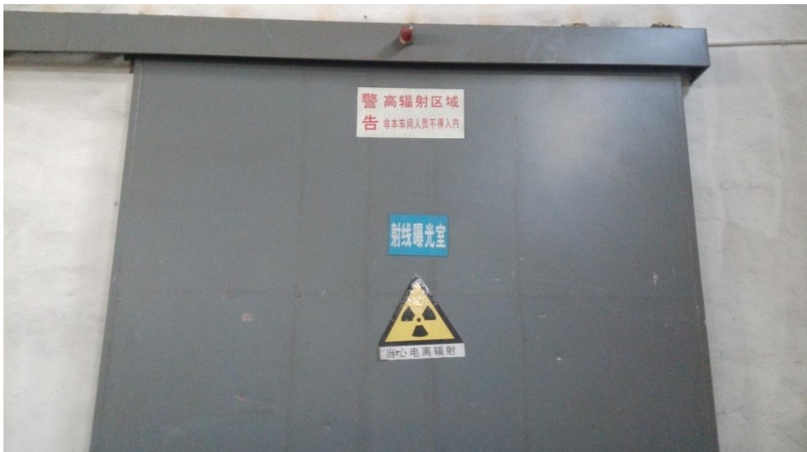
图 6-2 探伤室防护门、电离辐射标志及警示灯
