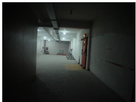
图 6-12 二楼加速器主机房
