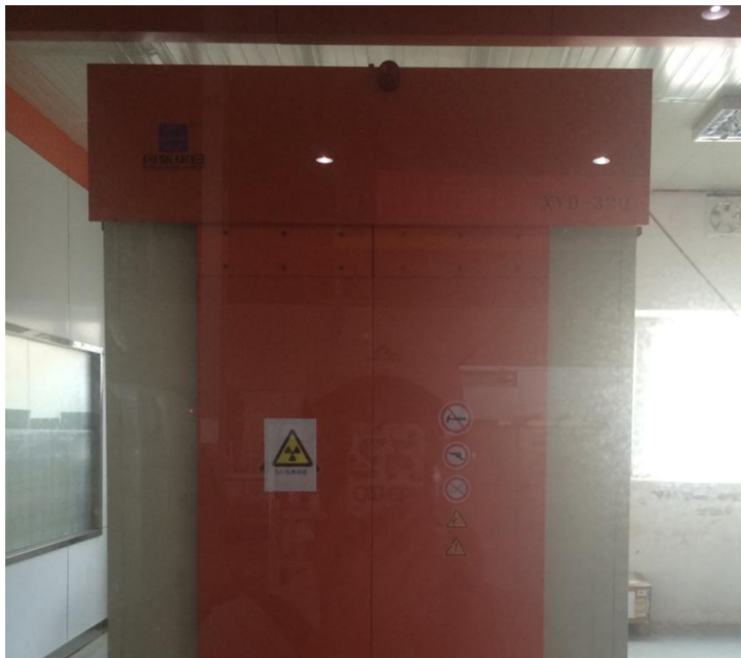
图 6-2 探伤室防护门、电离辐射标志及警示灯
