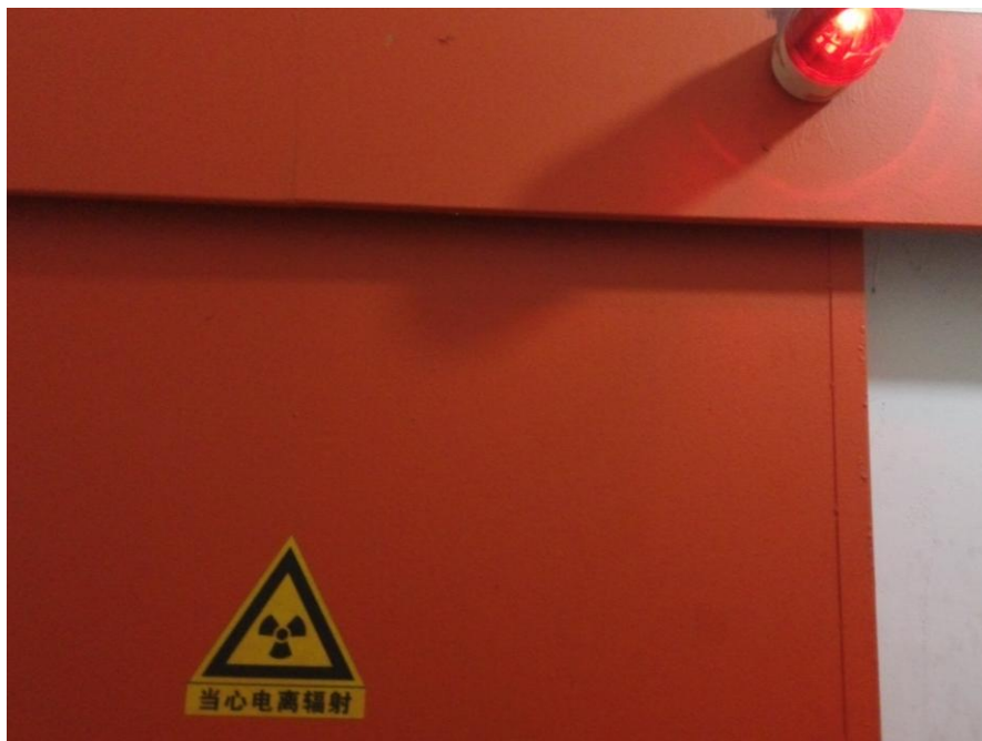
图 6-2 探伤室防护门、电离辐射标志及警示灯
